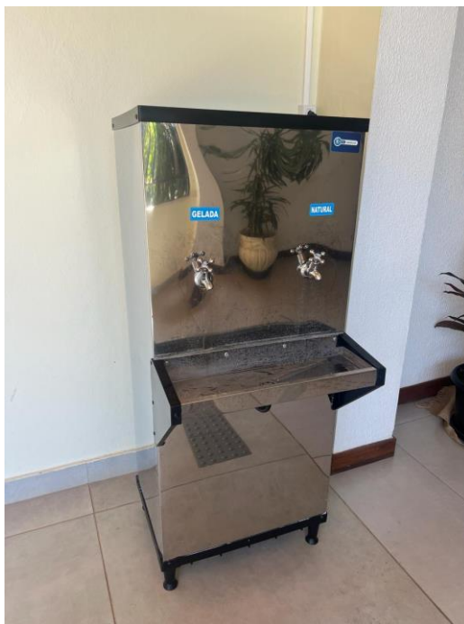
Bebedouro instalado no Prédio A.
