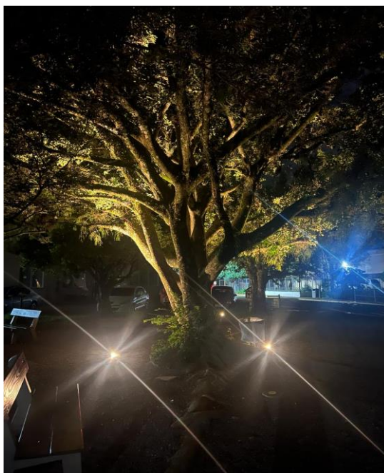
Iluminação em praça e rua próxima ao Prédio C.
